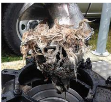
Verstopfte Pumpen, aufwändige Instandstellung.
